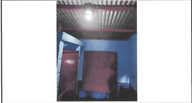
Foto 8: Mantenimiento del Sistema Electrico existente 4 lamparas, 2 toma corrientes y 4 plafoneras y cable calibre 12
